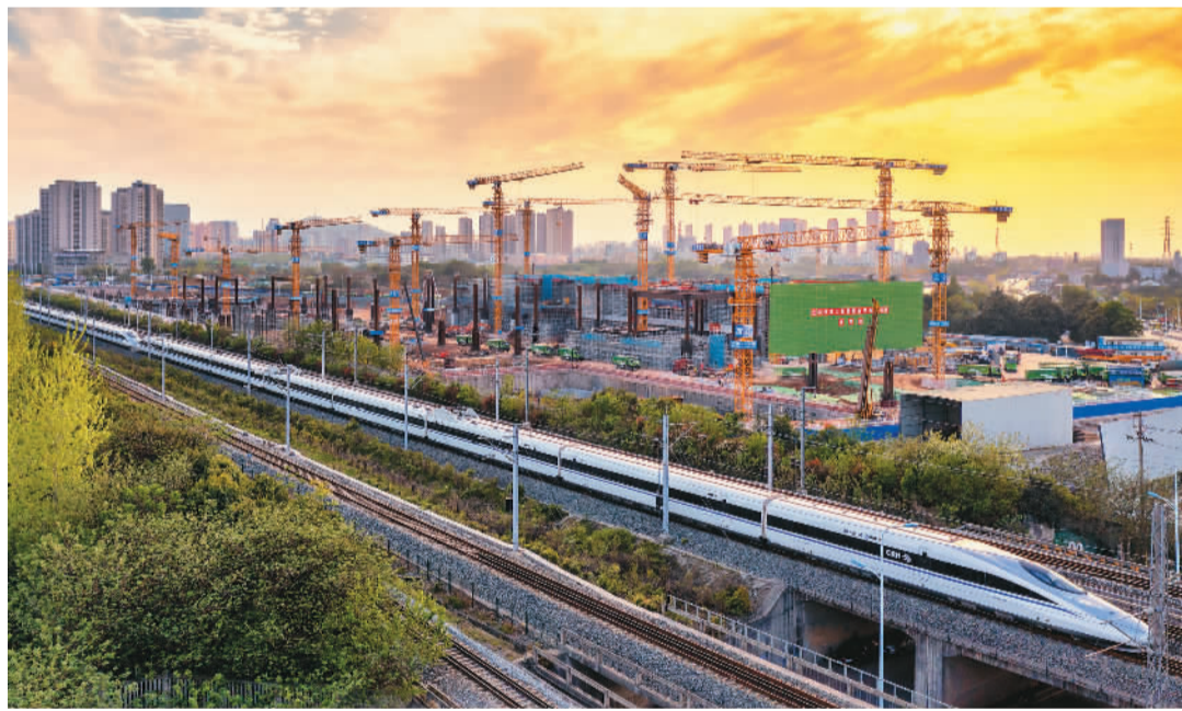
近日,安徽合肥西站站房主体结构工程施工如火如荼,项目综合开发及东广场项目超深基坑支护工程也在同步施工。据悉,合肥西站站房规模设计为8台18线,高架站房面积8万平方米,建成后将与合肥站、合肥南站共同构成合肥铁路枢纽“三足鼎立”的客运系统布局。
