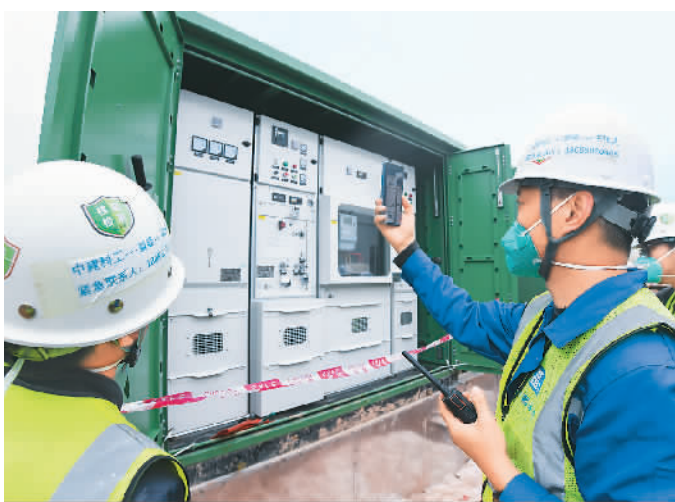
三月二十九日,在中央援港应急医院一期施工现场,中建科工工作人员与港方视频连线。新华社记者 梁旭摄
