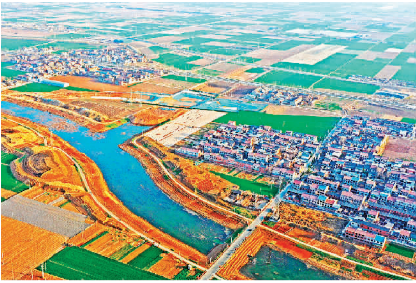
▲ 3月10日拍摄的正在建设中的河南省西霞院水利枢纽输水及灌区工程孟州段。该工程是节水供水重大水利工程之一。
