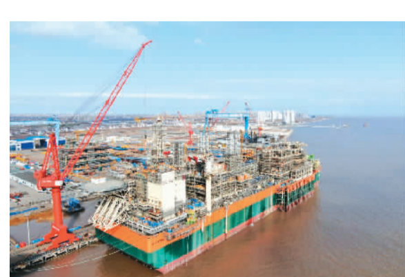
图为1月21日拍摄的由江苏启东中远海运海工承建的浮式生产储卸油船N999 FPSO项目。N999 FPSO是中国船企首次为非洲项目建造的浮式生产储卸油船。目前已经完成了所有上部模块的吊装，进入完工调试阶段，预计年底前交付。 许丛军摄（人民图片）
