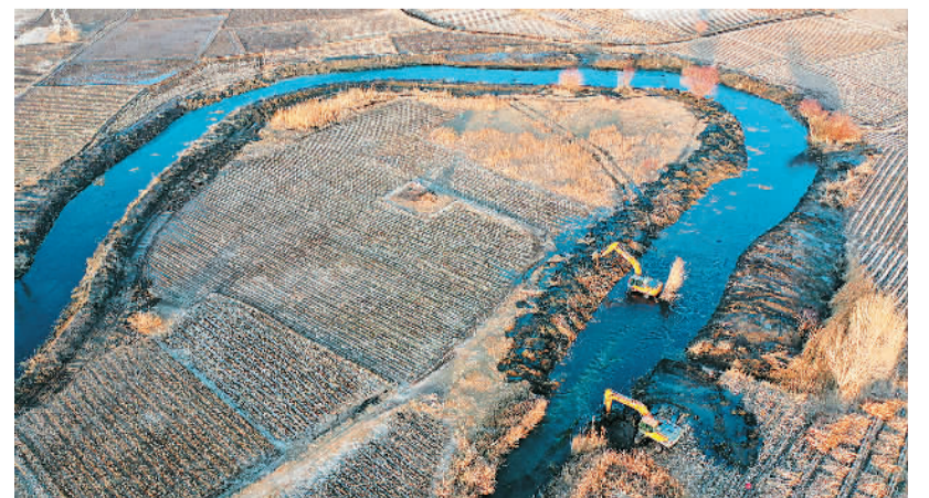
2021年11月18日，甘肃省张掖市甘州区三闸镇三闸村新河流域，施工人员在河道实施拓宽、清淤、疏浚。
