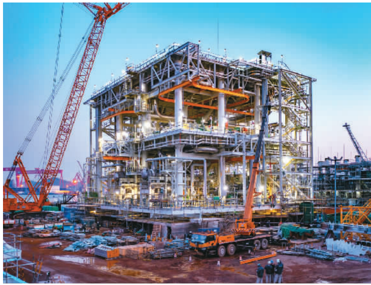
由中国海油旗下海油工程公司负责建设的加拿大LNG（液化天然气）项目首个核心工艺模块近日在青岛场地完工交付，该项目首次实现核心工艺模块加管廊模块一体化联合建造，标志着我国LNG模块化工厂建造能力达到国际先进水平。
