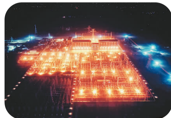
图为2021年4月10日,在巴基斯坦东部旁遮普省首府拉合尔拍摄的中巴经济走廊拉直流输电工程拉合尔换流站夜景。中国国家电网有限公司供图(新华社发)
