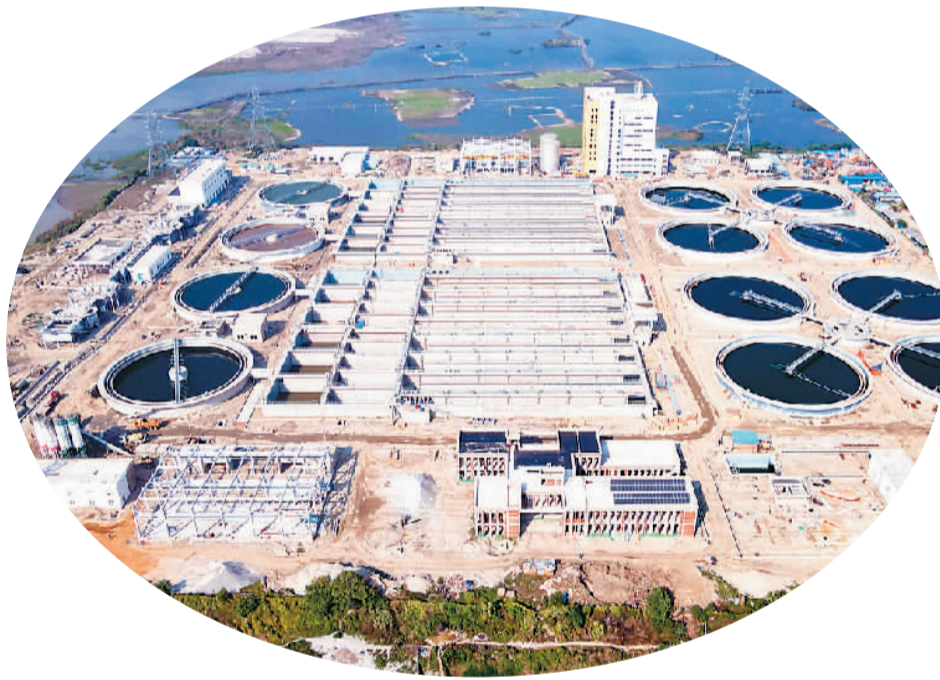
▲ 由中国企业承建的孟加拉国达舍尔甘地污水处理厂项目近日顺利通水，标志着项目进入试运行阶段。图为达舍尔甘地污水处理厂主厂区。
