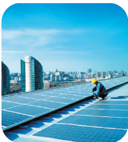
为高标准兑现北京2022年冬奥会和冬残奥会可持续性承诺,推动城市绿色发展,北京市积极实施六大阳光工程。图为工人在北京的国际大厦楼顶对分布式光伏项目进行最后调试。本报记者 贺勇摄
