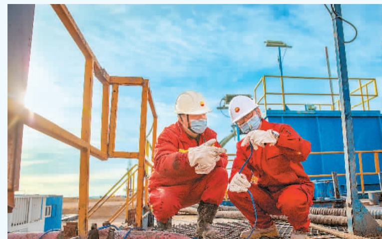
“油改电”是指将柴油用电替代做为钻机的动力，电驱钻机生产过程更加清洁环保，能源消耗大幅降低。图为中国石油新疆油田分公司玛湖油田生产现场，开发公司人员在油改电钻机现场检查线路。 张昉摄（人民图片）
