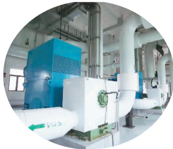
核能供热首站里的管道。资料图片
