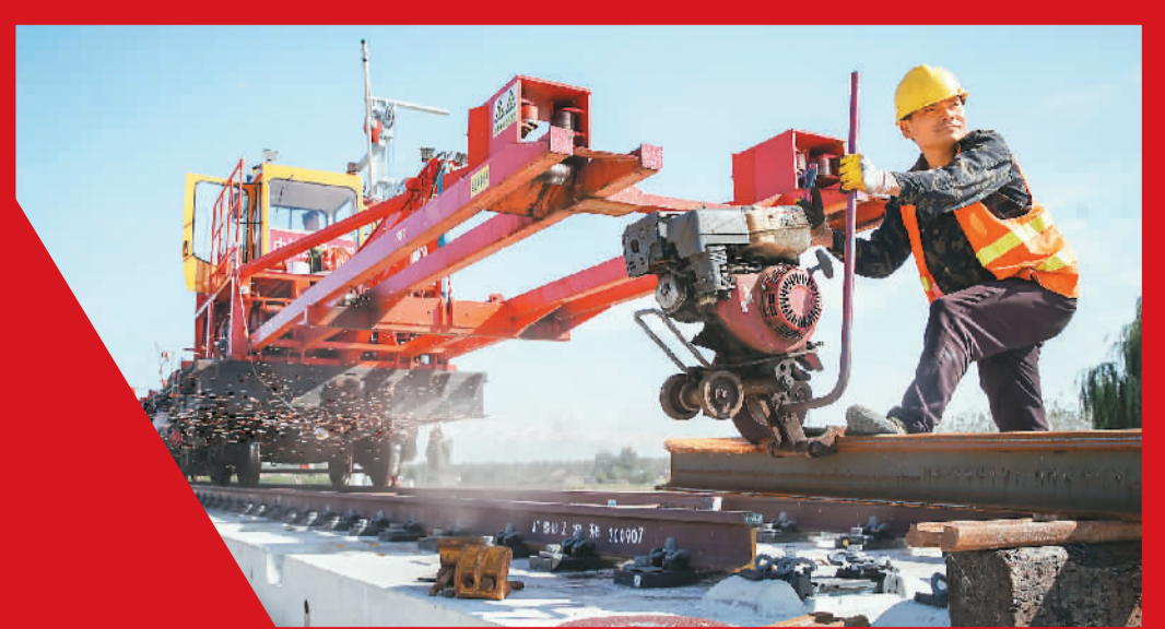
▲京唐城际铁路建设工程是京津冀协同发展重点项目，预计2022年建成通车。图为施工人员在现场切割钢轨。 邢子鸣摄（人民视觉）
