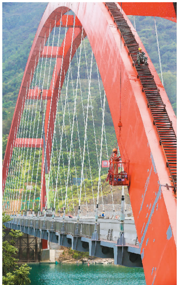
作为安徽省歙县新安江沿线两岸群众“渡改桥”重点工程和巩固脱贫攻坚成果的关键性民生工程，新安江跨江大桥各项施工正在全力冲刺，以保障10月1日前通车。图为9月12日，工人进行拱圈喷漆施工。
