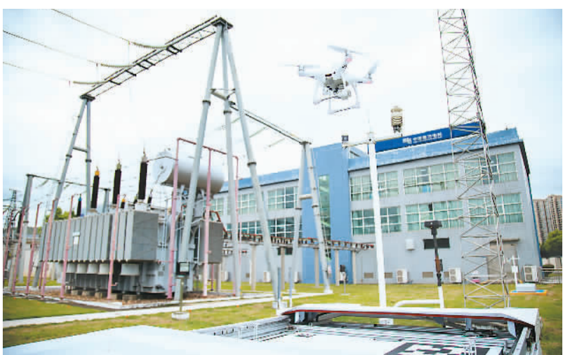
近年来，广东电网公司积极推广应用无人机等智能装备，不断提升当地供电可靠性。截至目前，该公司在主网线路实现无人机设备巡视的基础上，已完成配网全部可飞线路、基杆塔的精确定位自动驾驶航线规划。图为无人机进行自主巡视任务。 孔德晨 潘跃鹏摄（人民视觉）
