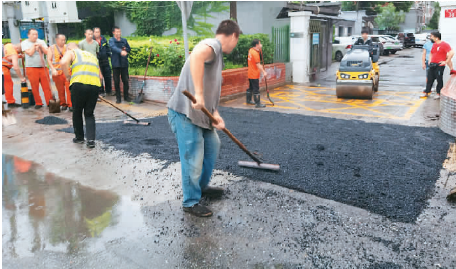
7月29日,北京市海淀区永定路街道应急分队队员对居民通过12345热线反映的不平坦道路进行维修。 鹿艺佳摄
