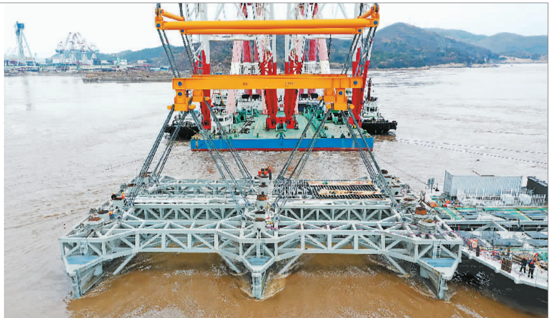
LHD海洋潮流能发电项目第四代1.6兆瓦机组正在安装，预计今年10月下海并网运行。
