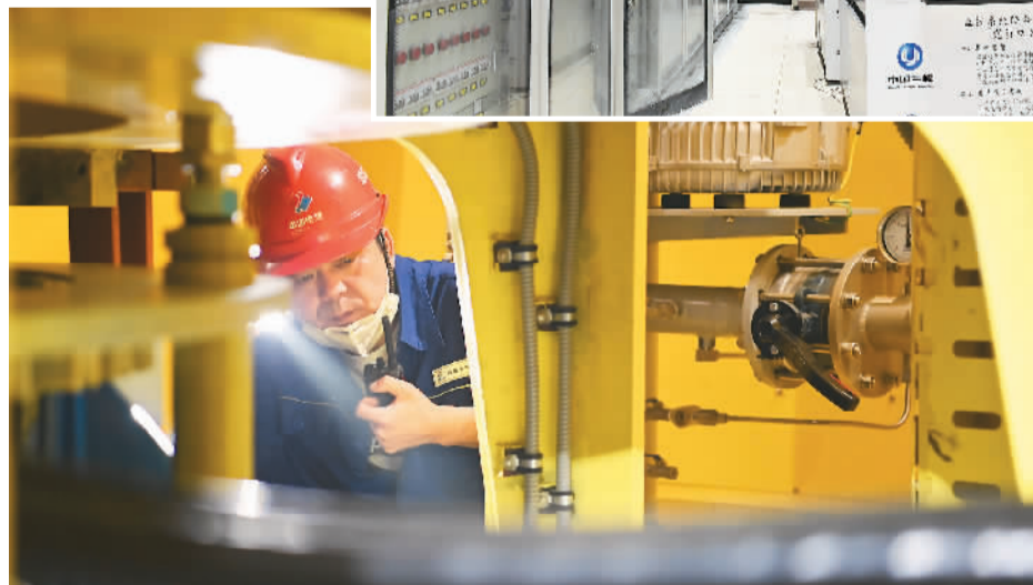
6月8日，在白鹤滩水电站左岸机房，工作人员在观察1号机组运转情况。 新华社记者 胥冰洁摄
