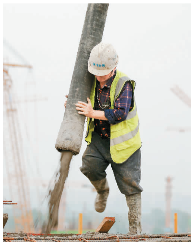
▲ 在河南洛阳，中建八局承建的洛阳市奥林匹克中心项目上，一位工人正为体育场五层梁板浇筑混凝土。 王光晨、白新宇 摄
