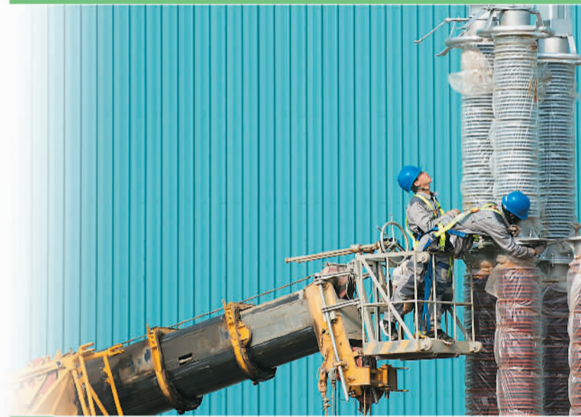
▲在张北柔性直流电网±500千伏康保换流站工程现场，施工人员正在吊装桥臂电抗器。 邹明摄
