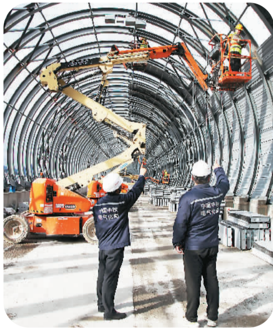
▲2月27日,在杭绍台城际铁路浙江省台州市路桥区桐屿街道路段,中铁电气化局的建设者正在铁道上安装隔音设施。 蒋友青摄(人民视觉)
