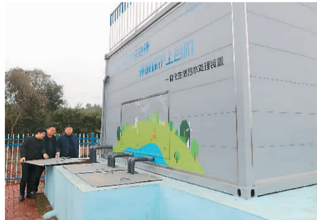
2月2日，在江西省抚州市东乡区圩坊乡艾田村集中式生活污水处理站，工作人员在查看投入使用的一体化生活污水处理装置运行情况。 何江华摄 (人民视觉)
