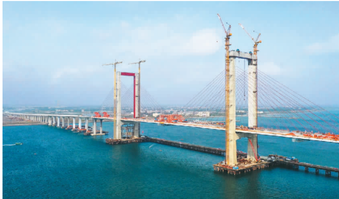
一月二十五日,湛江调顺跨海大桥成功合龙。新华社记者 刘大伟摄
