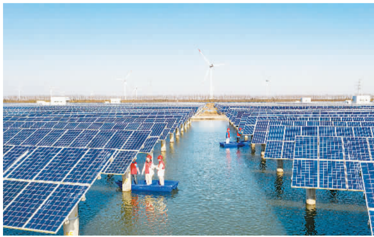
近年来，江苏省海安市滨海新区利用广阔的滩涂资源培育壮大太阳能、风能等新能源产业，有效实现节能减排的同时，推动地方经济绿色发展。图为日前电力作业人员在巡检光伏发电设施。翟慧勇摄（人民视觉）
