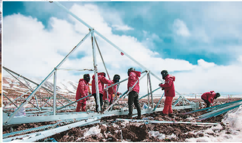
上图:普兰县境内的输电铁塔。徐驭尧摄 新华社发
