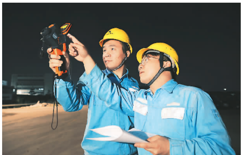
广东省江门市棠下镇近年发展起来一条饮食街，每到夜晚生意红火。为消除安全隐患，近日江门供电局对饮食街进行夜巡，确保商户用电安全。图为运维人员通过红外测温仪对设备进行检测。周倩影摄
