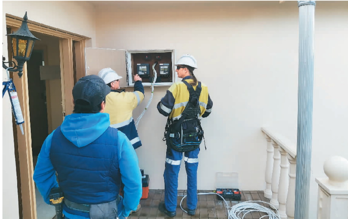
近日，澳大利亚墨尔本北郊温区，澳大利亚嘉源智能模块化建筑公司在检查房屋供电设施。受访者供图
