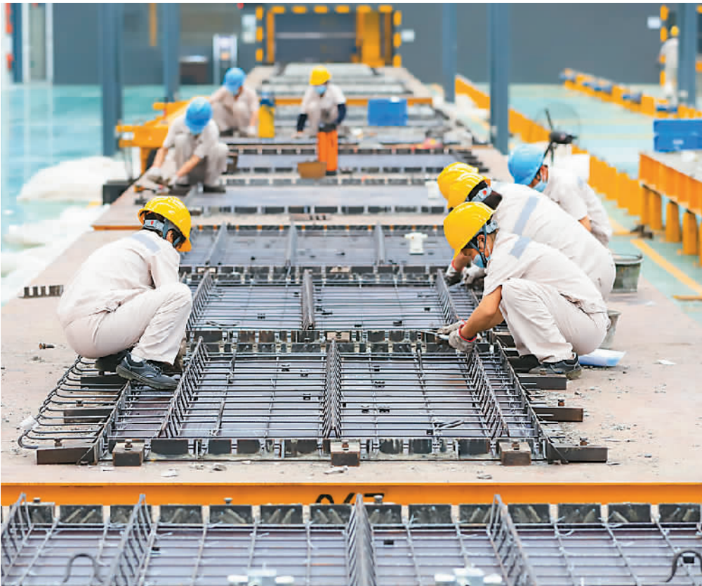
位于江西省湖口县高新技术产业园区内的置地远装配式建筑工厂里，工人们正在进行置筋作业，加紧赶制订单。张 玉摄（人民视觉）
