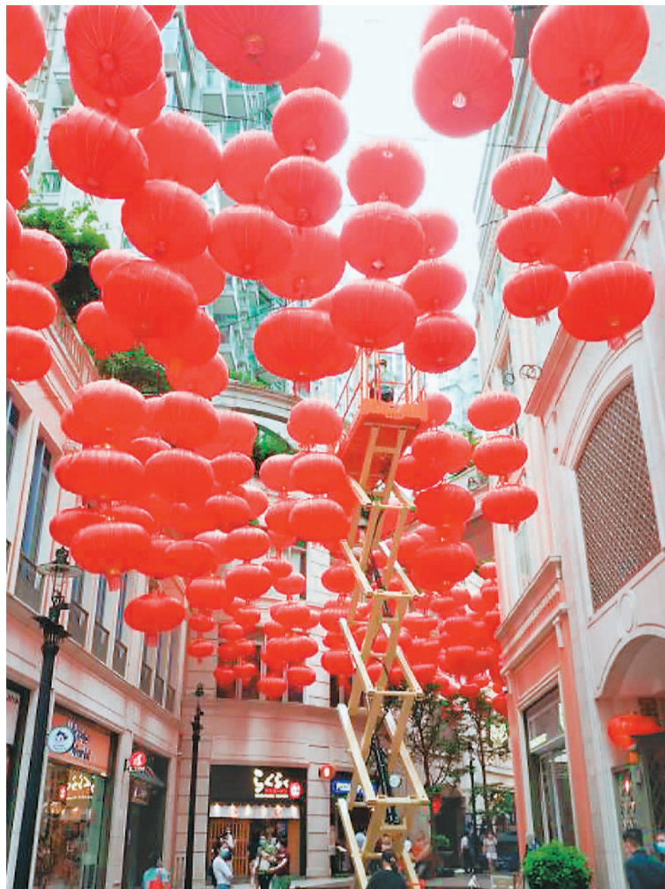
在香港湾仔利东街，工人正在安装红灯笼，迎接国庆、中秋的到来。 中新社记者 张炜摄
