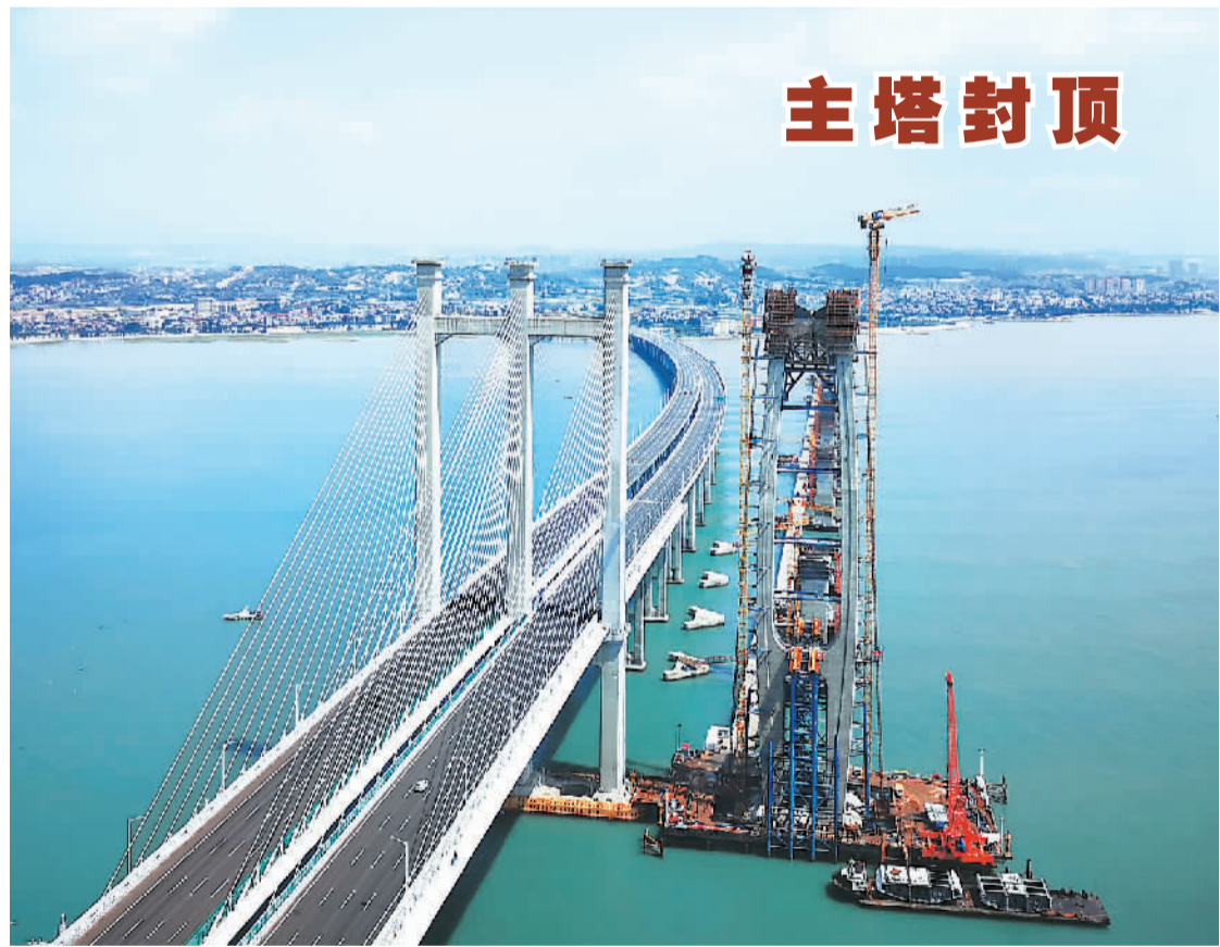
9月15日,福州(门)高铁泉州湾跨海大桥南岸主塔成功封顶。泉州湾大桥全长20.29公里,是世界首座设计时速达350公里的高铁跨海斜拉桥。预计2022年通车运营后,福州至厦门行车时间将缩短至1小时以内。图为施工中的大桥南岸主塔。
