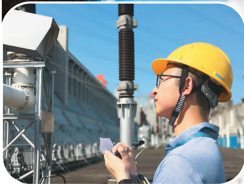
▲三峡电厂员工正在巡检三峡厂房出线设备。江雨摄
