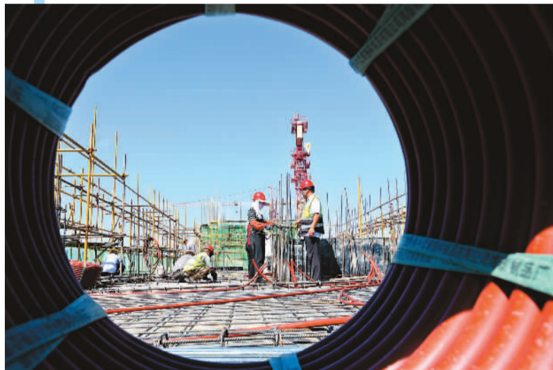
甘肃张掖市民乐县生态宜居搬迁工程建设现场，建筑工人正在高空进行脚手架搭建。 王将摄（人民图片）
