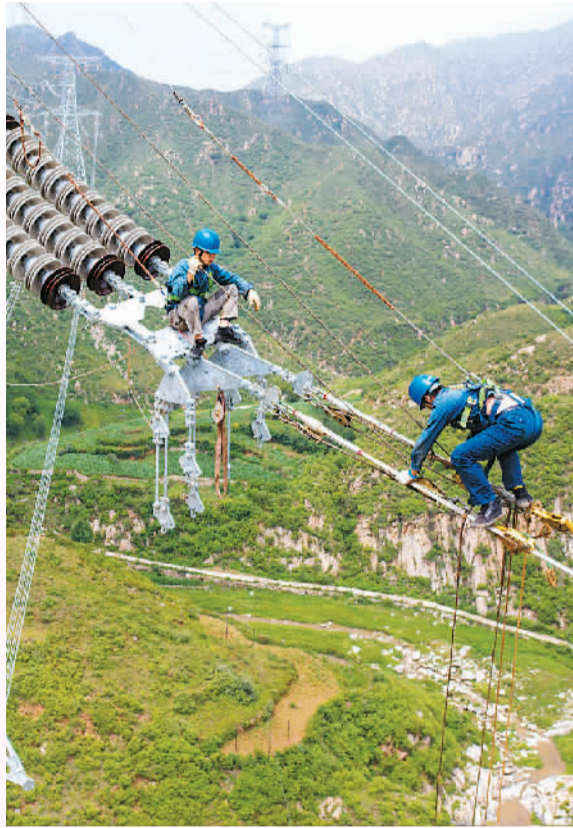
张北——雄安1000千伏特高压交流线路工程是服务雄安新区的首条清洁能源大通道，建成后每年可为雄安新区输送70亿千瓦时清洁能源。图为7月10日，在河北省保定市涿源县乌龙沟乡，工人进行特高压工程架线作业。 郑贤烈摄（人民图片）
