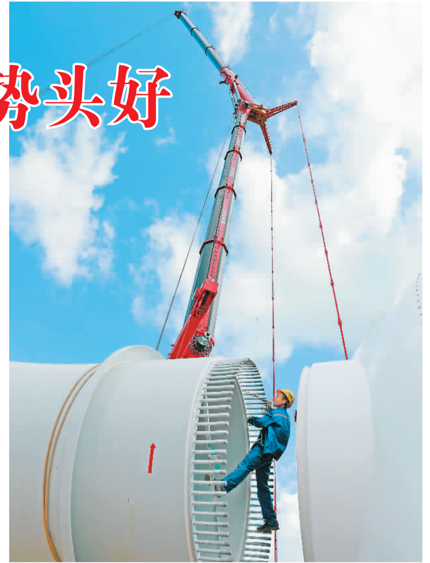
江西省吉安市泰和浪川风电场项目装机容量为一百四十兆瓦，其中一期总投资五亿元，预计安装三十二台风电机组，发电容量八十兆瓦，每年将提供十六亿千瓦时的清洁电力能源。图为八月二十日，该项目一期施工现场，工人们在实施风机吊装作业。 谢子洋摄（人民视觉）
