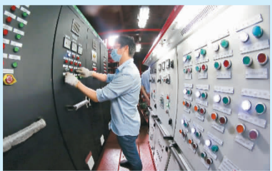
长江流域千吨级纯电动货船“中天电运001”号在江苏常州试航。图为工作人员在测试货船内的电力控制系统。 陈曦摄（人民视觉）
