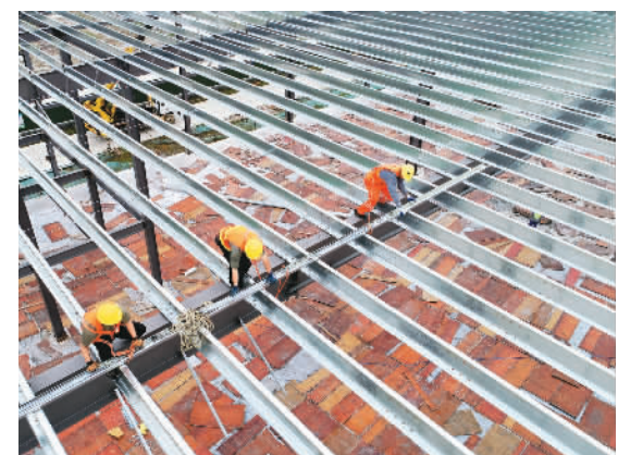
7月2日，“一带一路”供应链基地（连云港）项目现场，工人正在安装屋面檩条拉筋。 王健民摄（人民视觉）
