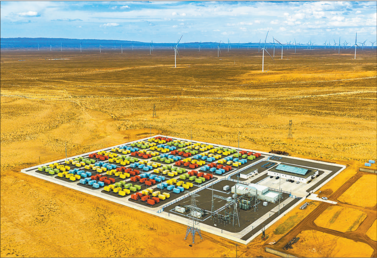
近年来,甘肃省张掖市临泽县推进新能源项目建设,光伏治沙基地、独立储能电站等一批重点工程相继落地,形成“发电+储能+外送”的完整产业链。图为7月28日,临泽县北部滩新能源产业园里,储能电站与风电项目正稳定运行。 杨 摄(影像中国)
