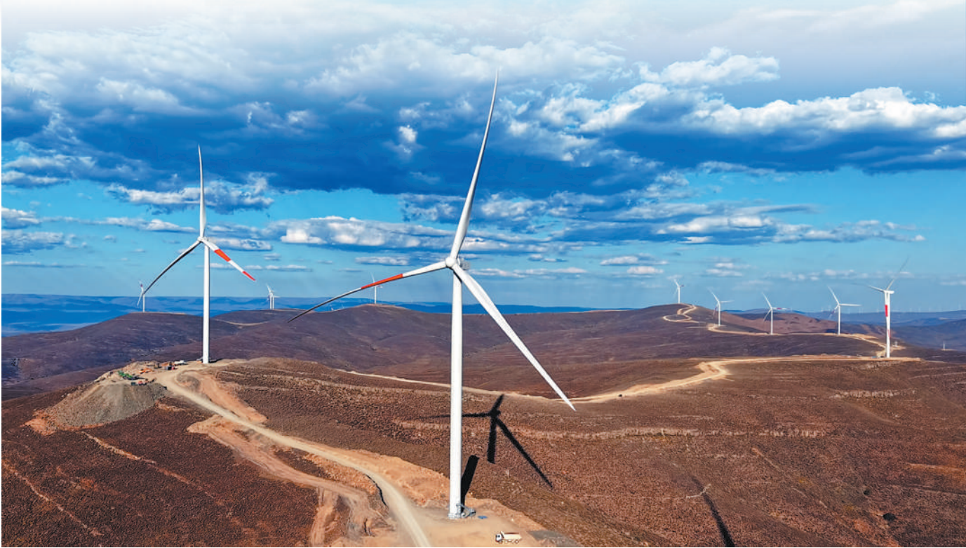
由中国电建承建的南非奥亚混合能源项目风电设施。
