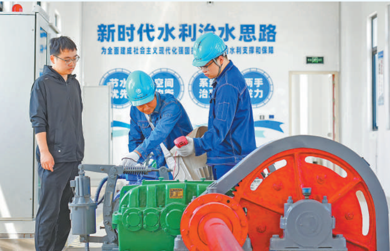
安徽滁州市定远县江巷水库排灌站,技术人员对站内电力设施进行检修维护,确保防汛抗旱用电需求。
