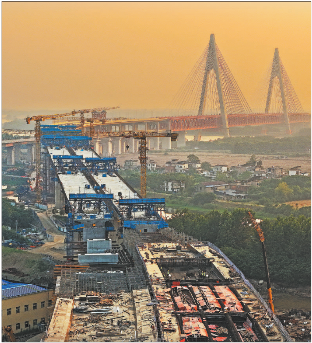
日前，安徽省马鞍山市当涂县境内，巢马高速铁路马鞍山长江公铁大桥公路接线工程抢抓施工窗口期，推进接线工程建设。巢马高速铁路建成后将进一步织密皖江高铁网络，畅通区域要素流通。图为施工现场沐浴在夕阳暖晖中。
