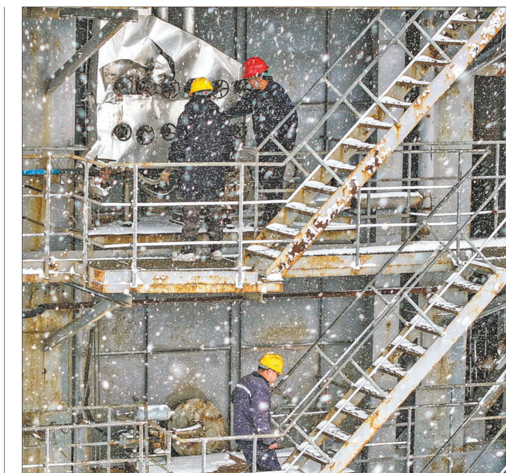
受寒潮影响,2月6日起我国中东部自北向南陆续迎来大风降温天气。多地积极应对,做好防范措施。图为2月7日,山东省荣成市热电厂工作人员巡检锅炉设备。李信君摄(影像中国)
