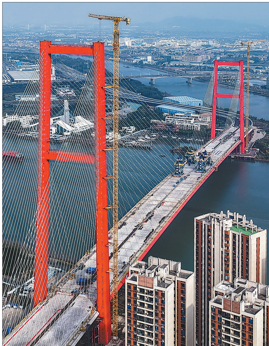
前不久，广东顺德大桥顺利合龙，未来大桥通行后有助于佛山顺德区融入粤港澳大湾区“一小时交通圈”。新华社记者 刘大伟摄
