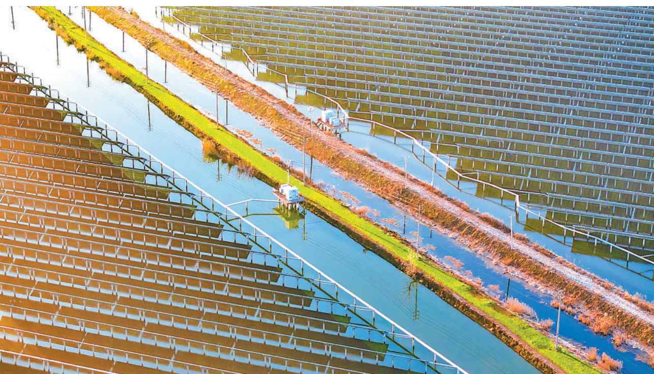
近年来，江苏省东海县不断推动渔光互补项目建设，利用原有鱼塘、低洼地等发展水上发电、水下养鱼的生产经营模式，有效带动农业增效、农民增收。图为1月7日拍摄的东海县曲阳镇渔光互补项目区。邵光明摄（影像中国）
