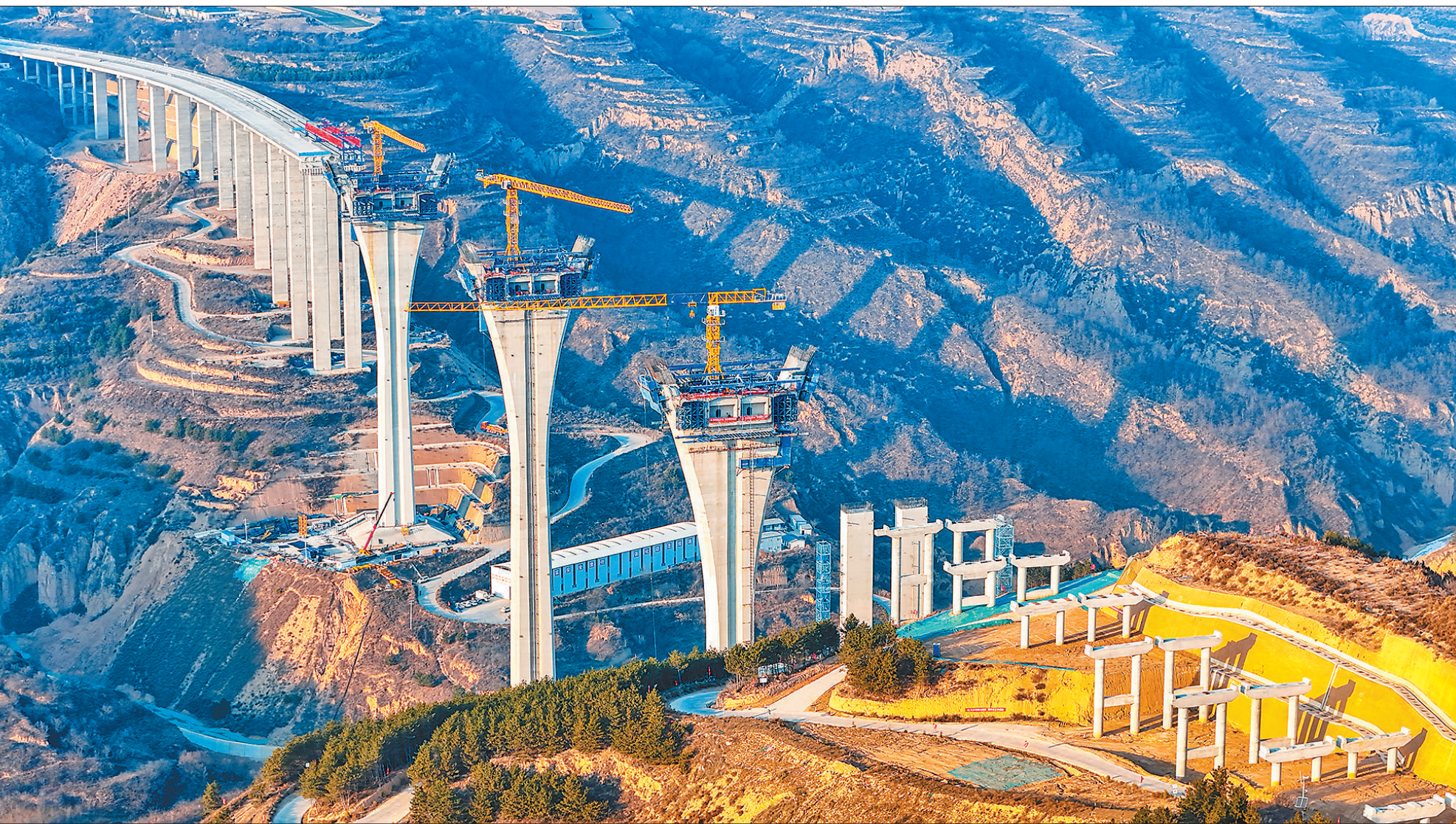
1月3日，建设中的G244线甘肅庆阳过境段火巷沟特大桥。G244线庆阳过境段公路项目是甘肃省“十四五”公路水路交通发展规划项目，计划于2025年完成建设任务。
