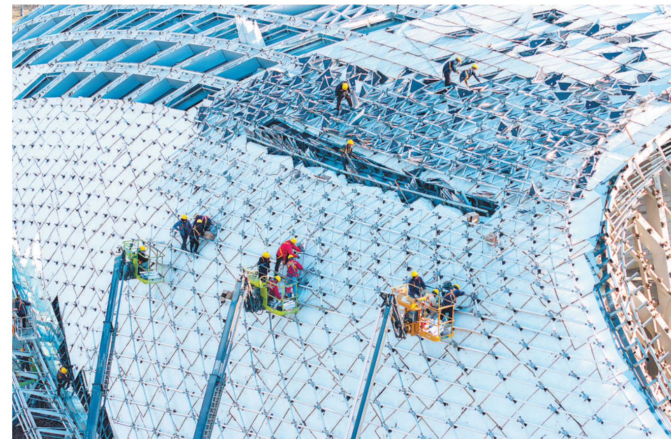
新年伊始,各地干部群众以更加饱满的精神状态在经济社会发展一线实干笃行,无数劳动者、建设者、创业者,都在为梦想拼搏。图为1月3日,江苏省宿迁市市民活动中心工地,工人们正在进行外墙装饰施工作业,现场一派忙碌景象。
