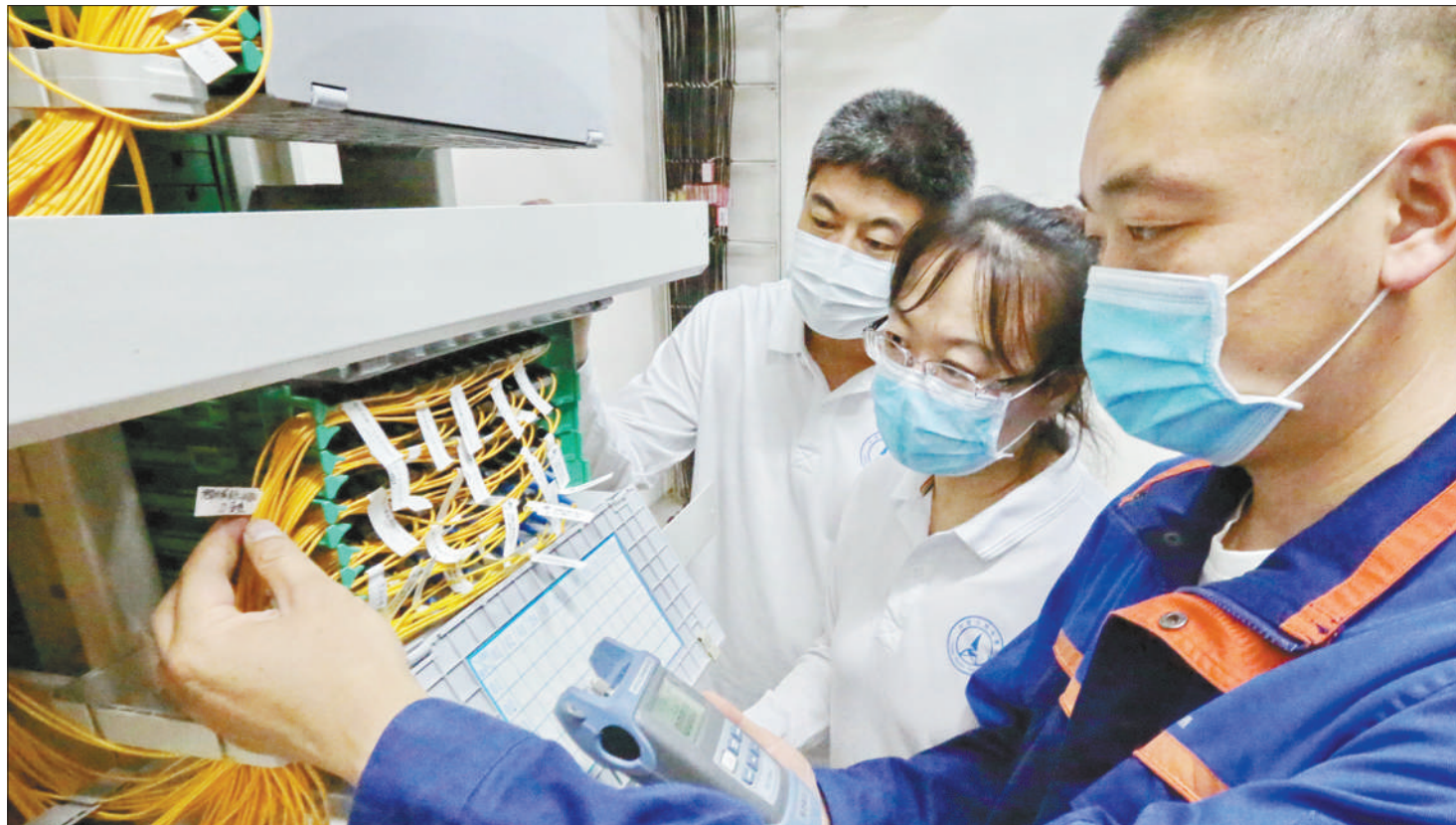
近日,秦皇岛无线电管理局工作人员与联通网络维护人员查看机房设备运行和信号发射情况,助力当地5G网络建设。 人民视觉
