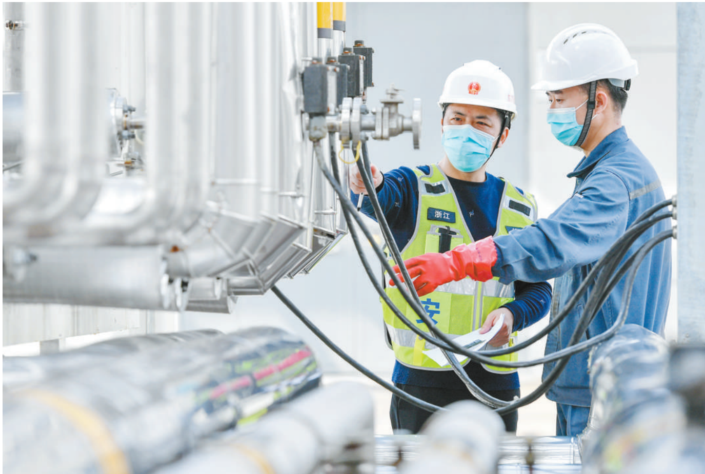
在浙江湖州市长兴县和平镇一家化工企业，县应急管理局的党员干部送服务助复工，正对生产设备进行隐患排查。 谭云俸摄
