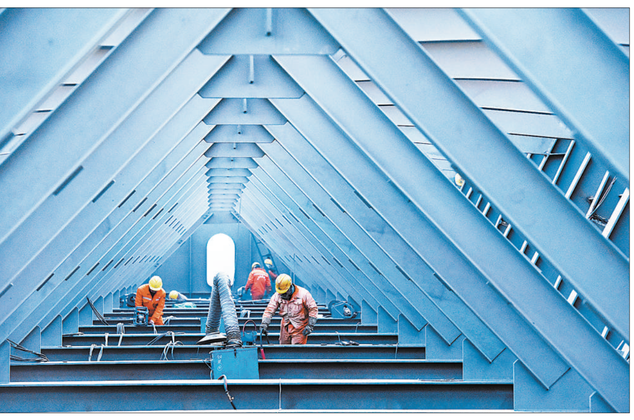
五州黄河大桥是207国道跨越黄河的重要工程,预计2021年建成,将对改善当地交通、促进黄河两岸地区经济协作发展起到巨大推动作用。图为近日,建桥工人冬日里冒着严寒为大桥刷漆。白水平摄(影像中国)
