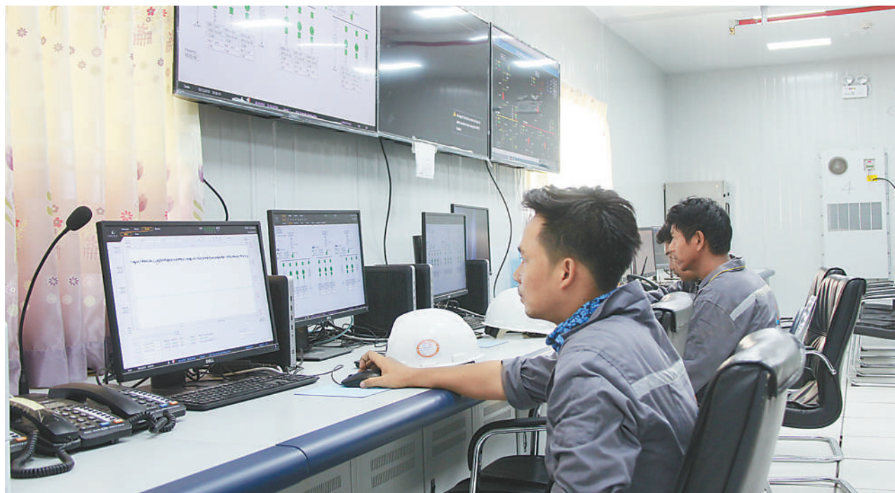
缅甸技术人员在皎喜电站主控室工作。
