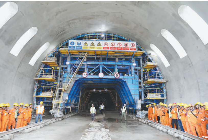
雅万高铁瓦利尼隧道入口。
