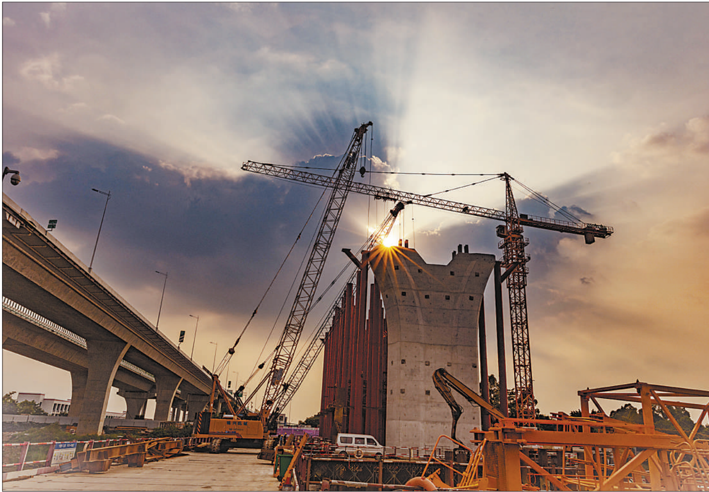
日前,由中国铁建十一局一公司承建的南沙港铁路西江特大桥工程在稳步、繁忙地推进中。
