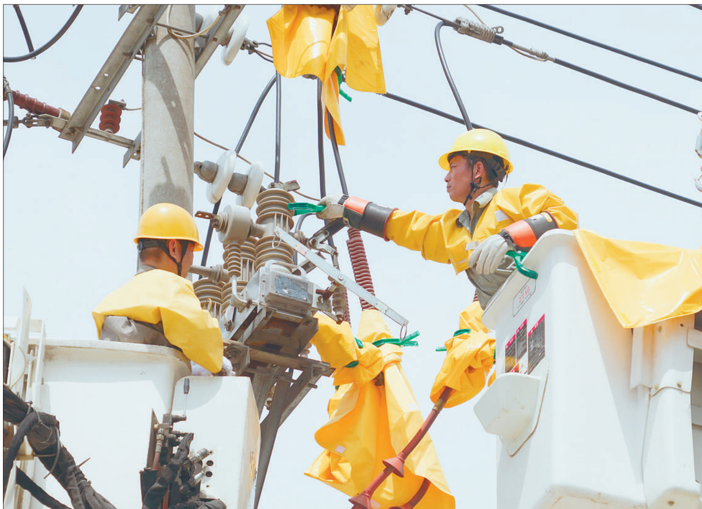
连日持续高温使江西省樟树市农村用电负荷不断攀升,樟树市供电公司加强对重点电力设备的维护巡视,确保“三农”用电需求。图为作业班工人正带电更换设备。肖明 龚可摄影报道
